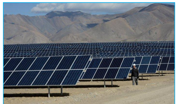
Quyosh elektr stantsiyasi
